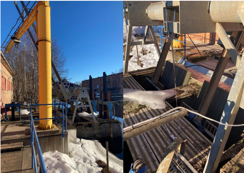
Figur 12 Pumpstation för pumpning av kylvatten och vatten till olika processer från Kolbäckån.
